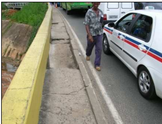
Figura 46 – Buraco sobre passeio da Ponte do Rio Camurujipe – 2008
