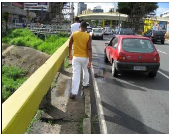
Figura 44 – Fissura apresentada no cimento da Ponte sobre o Rio Camurujipe
