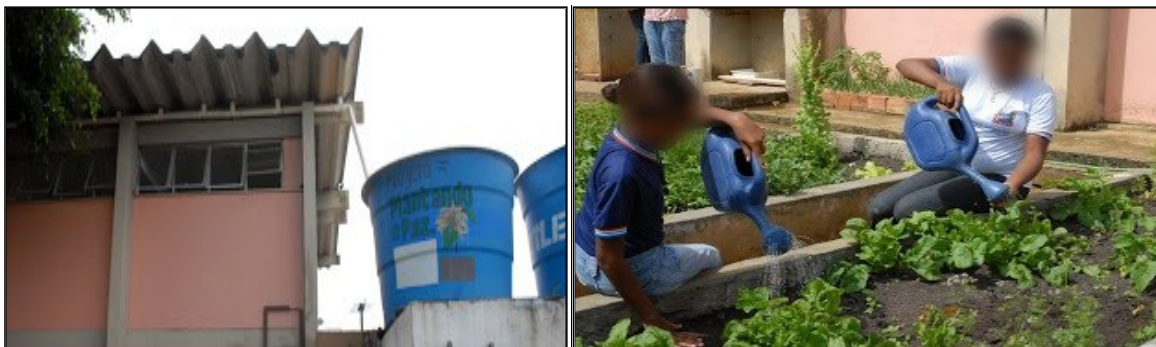
Figura 14 – Captação de água da chuva
