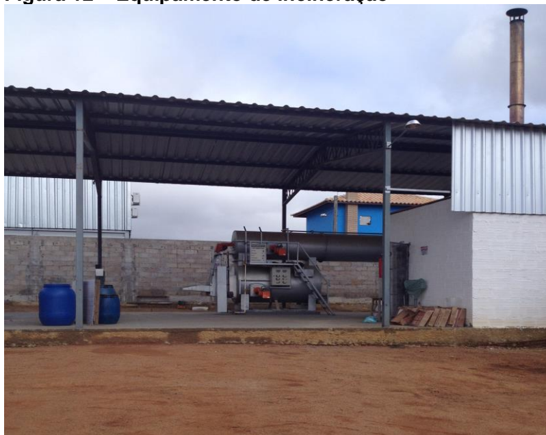
Figura 12 – Equipamento de incineração
