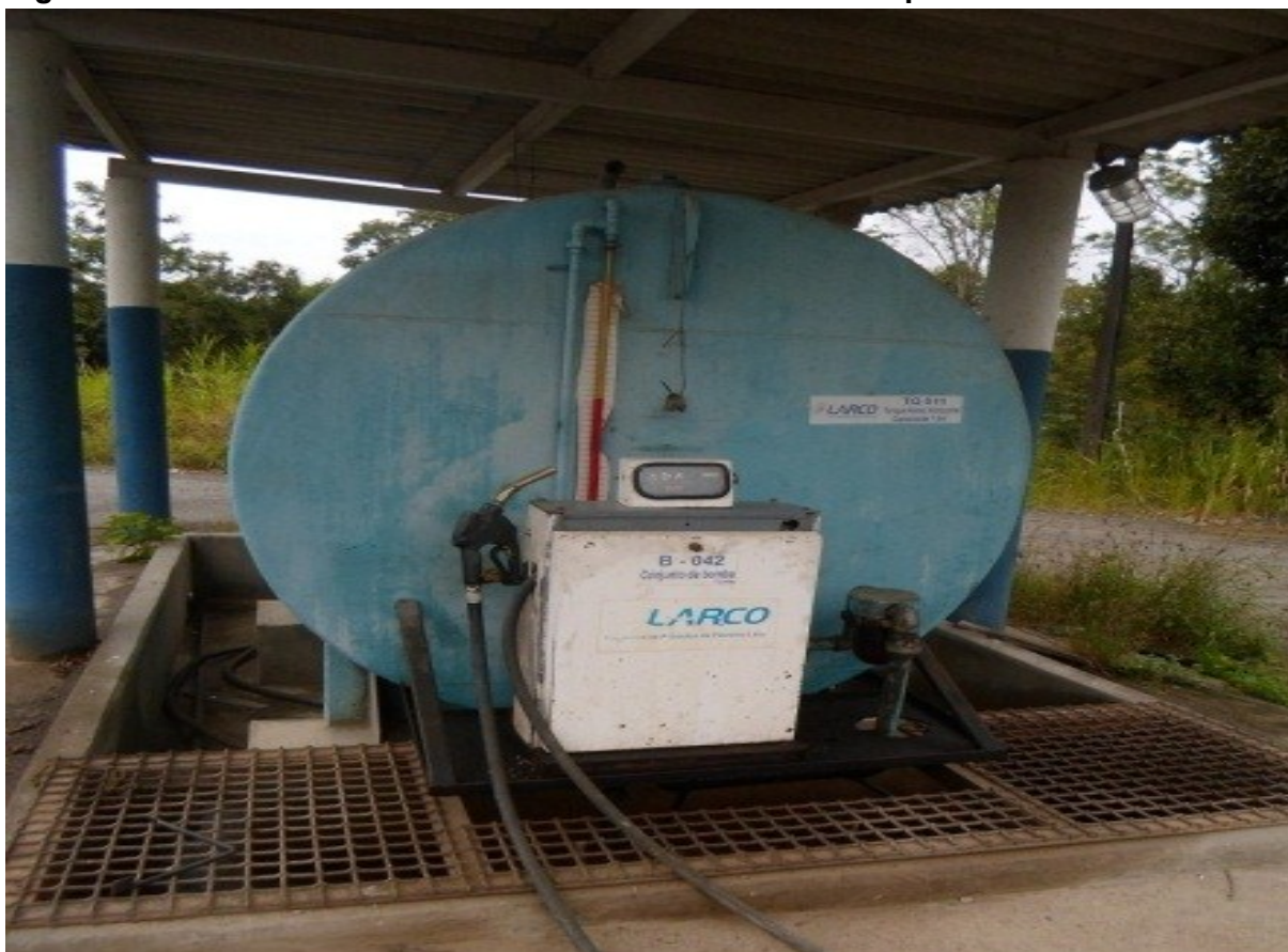
Figura 53 - Detalhe da bomba e da canaleta de dreno do tanque de combustível
