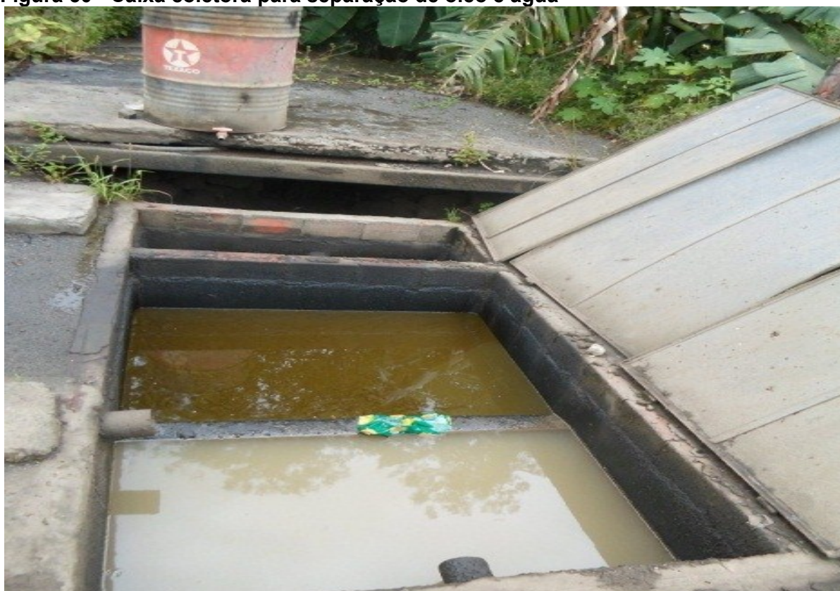
Figura 50 - Caixa coletora para separação de óleo e água
