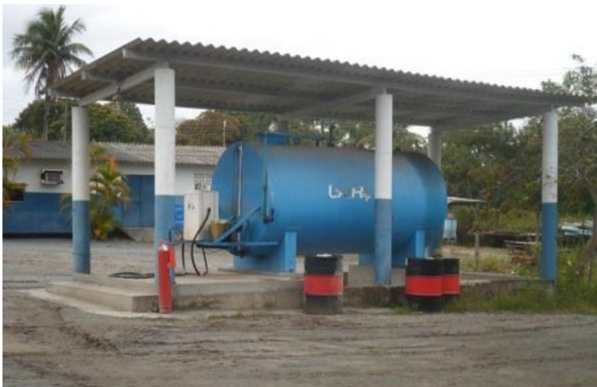
Figura 52 - Tanque de combustível (óleo diesel)
