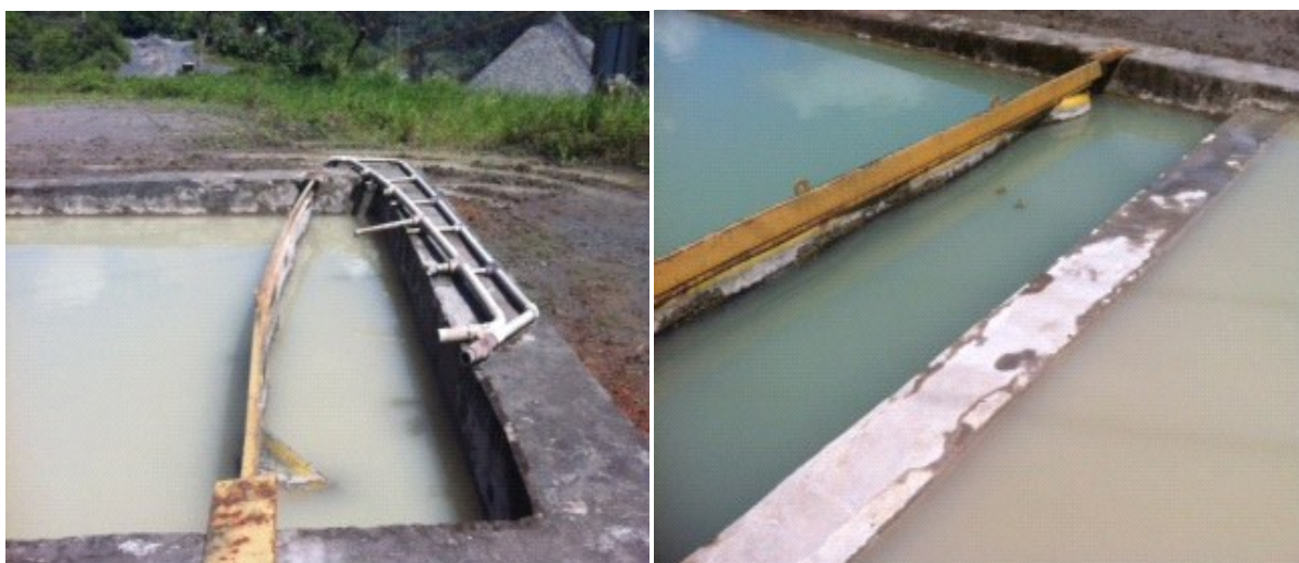
Figura 40 - Tanques de decantação de água
