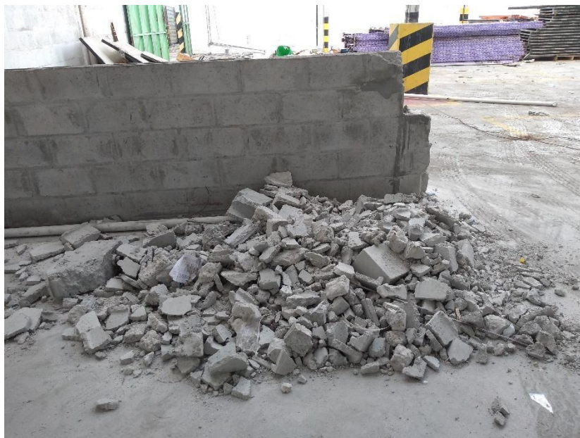
Figura 20 – Resíduos das paredes internas
