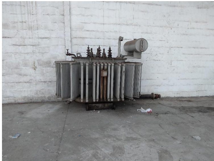
Figura 24 – Transformador de tensão elétrica
