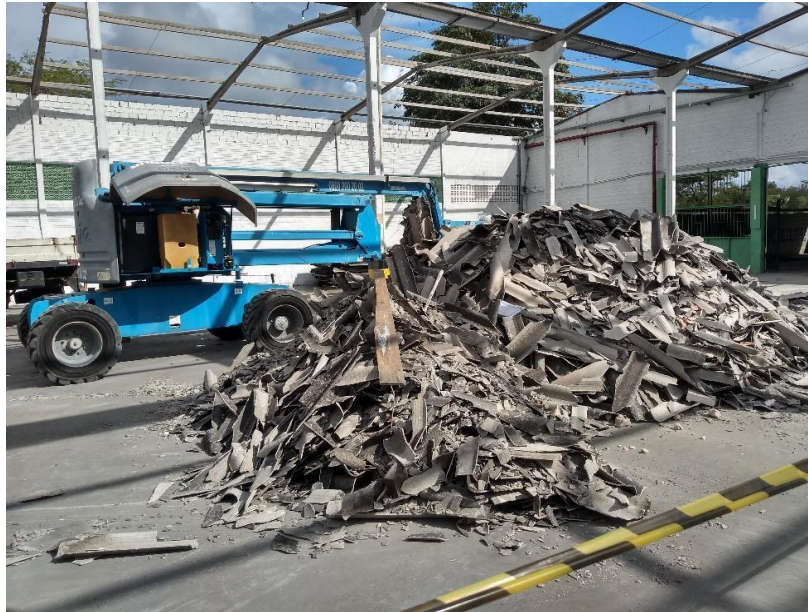
Figura 16 – Disposição dos resíduos de telha
