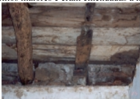
Figura 2 – Peças de madeira deterioradas
