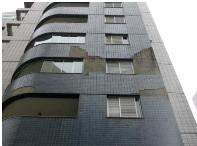
Figura 2: Deslocamento de peças cerâmicas em fachada.
