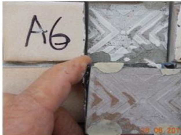
Figura 3: Vista do tardo de placa cerâmica sem argamassa aderida.
