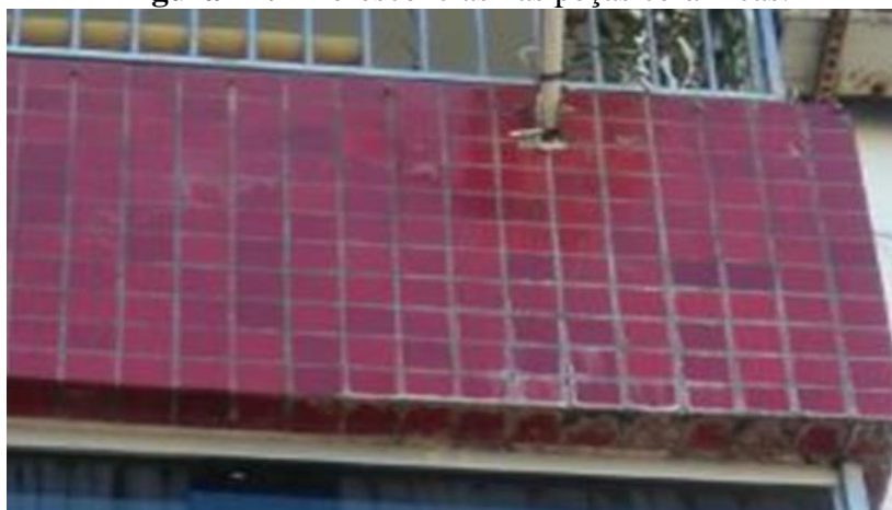
Figura 11: Eflorescências nas peças cerâmicas.
