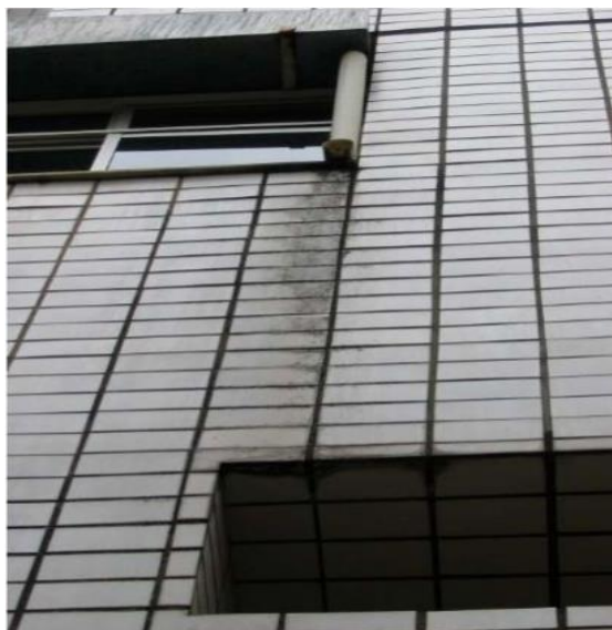
Figura 5: Manchas por infiltração nas peças cerâmicas.
