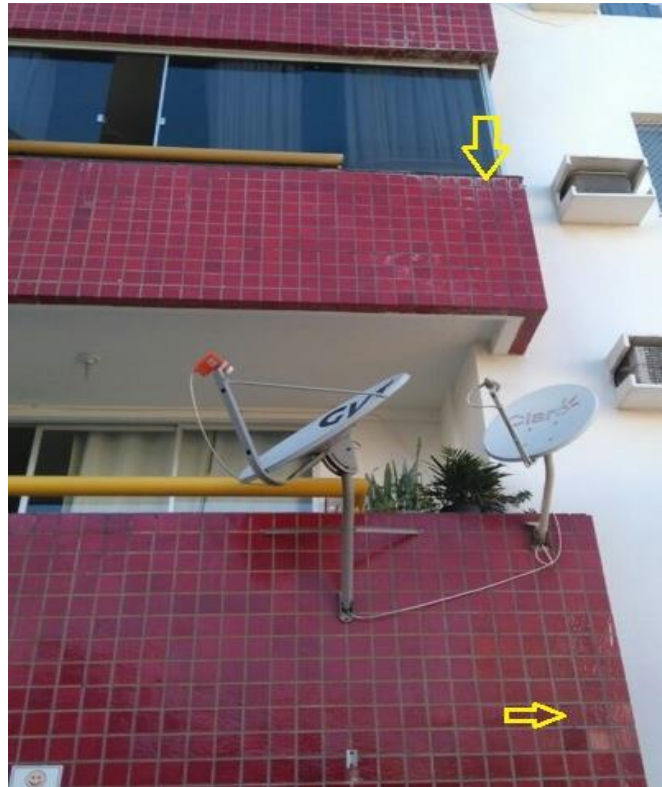
Figura 10: Manchas por infiltração nas peças cerâmicas
