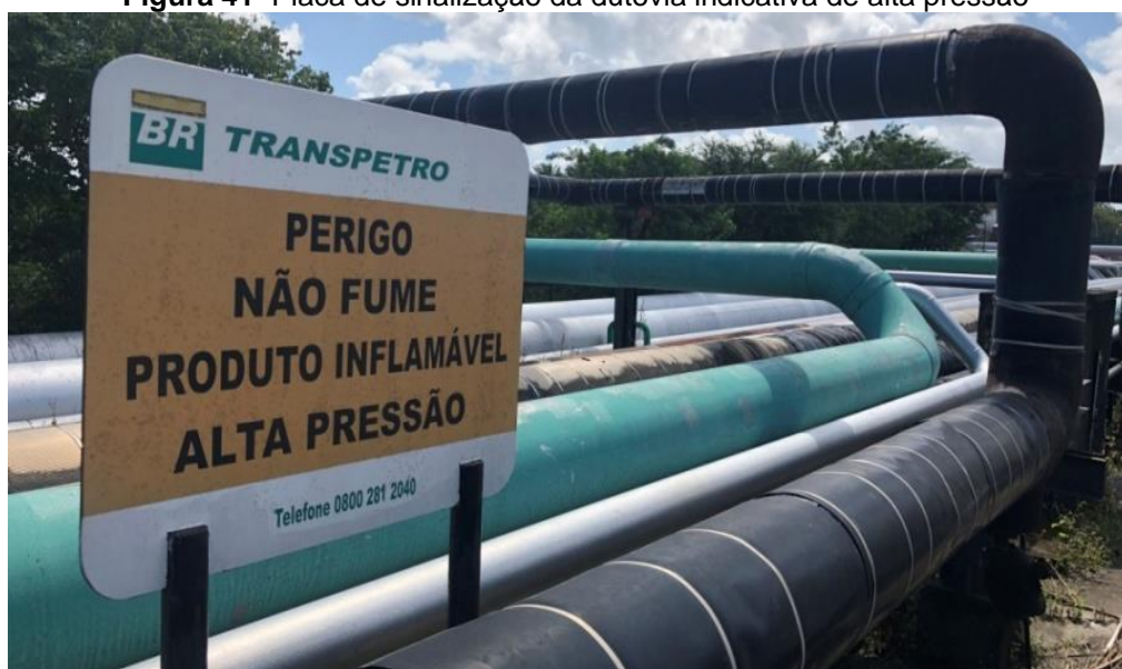
Figura 41 –Placa de sinalização da dutovia indicativa de alta pressão
