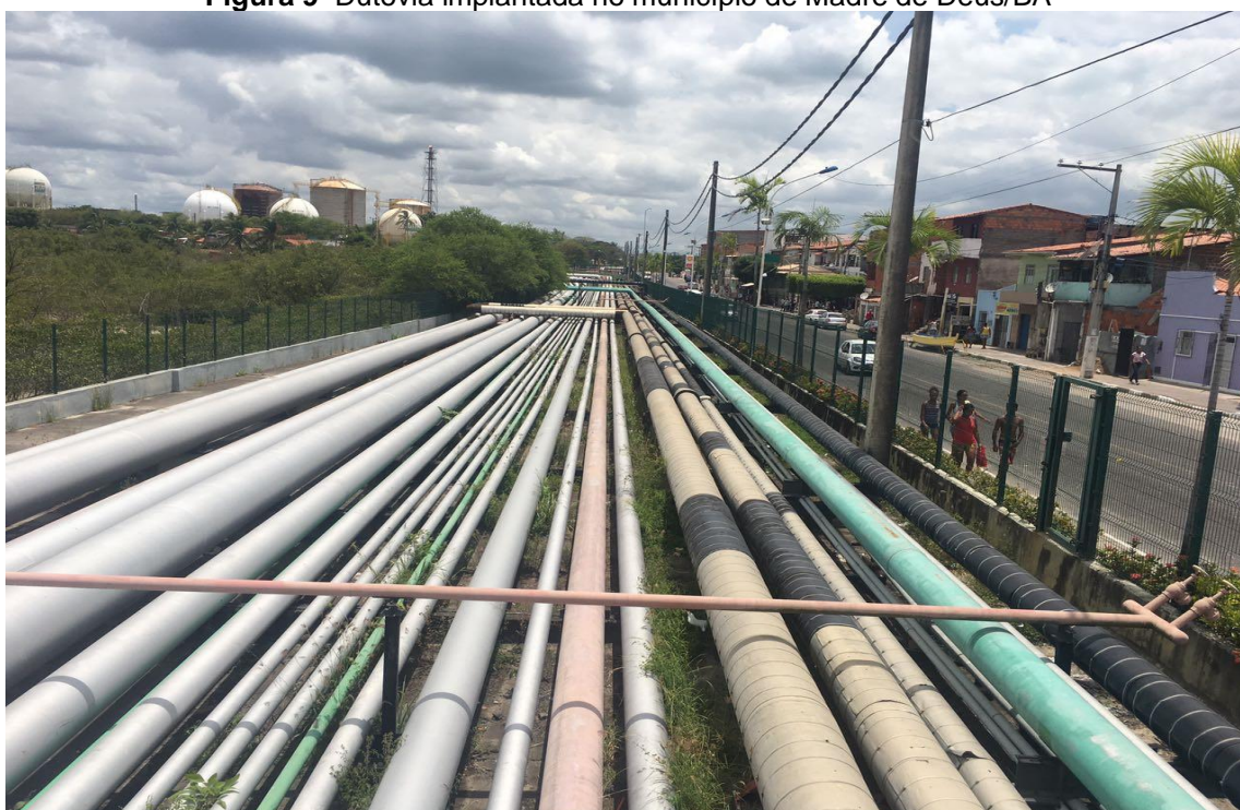
Figura 9 –Dutovia implantada no município de Madre de Deus/BA
