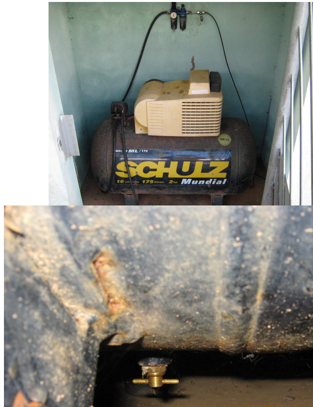
Figura 5 - Compressor e dreno.
