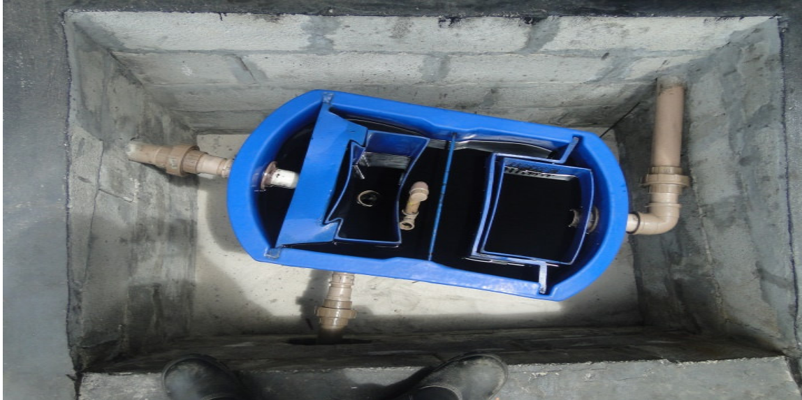
FIGURA 5: Caixa Separadora de Água e Óleo aberta – SAO
