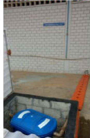
Foto 08 – Caixa separadora - SAO
