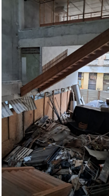
Figura 1 - Contraste entre inovação arquitetônica e manejo inadequado de RCC. Escola de Artes e Tecnologia, Comércio/Salvador
