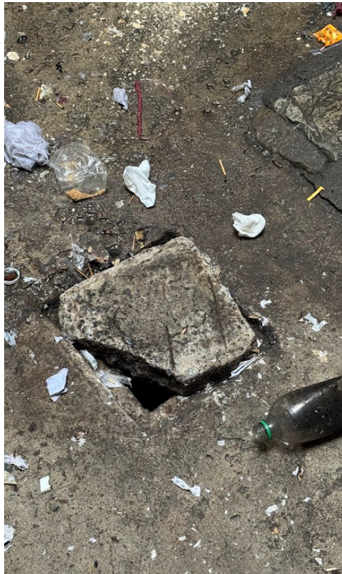
FOTOGRAFIA PESSOAL TIRADA EM 16/06/2025 - ALA B COM ESGOTO ABERTO, POR ONDE SAI ANIMAIS COMO RATOS E BARATAS.
