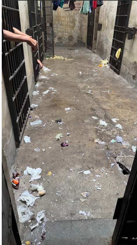
FOTOGRAFIA PESSOAL TIRADA EM 16/06/2025 - ALA B, COM ACÚMULO DE LIXO.
