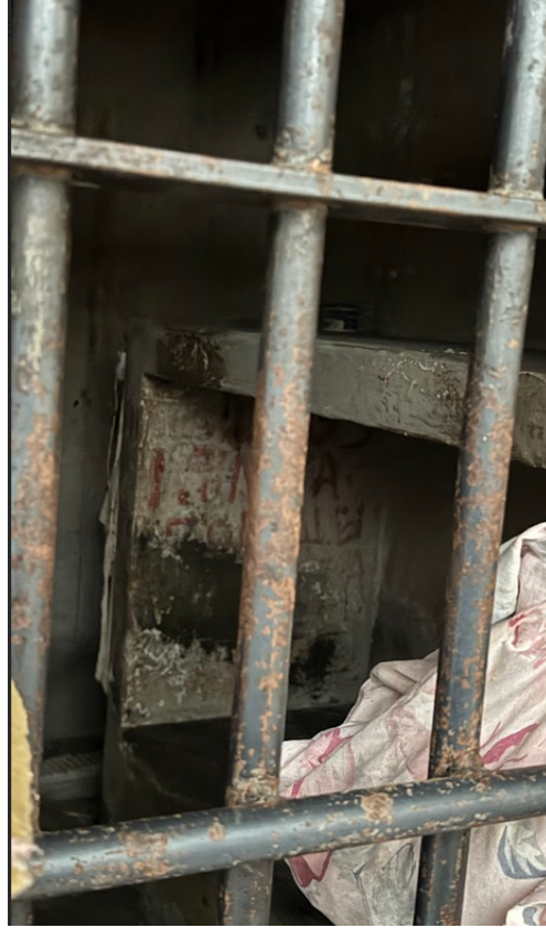
FOTOGRAFIA PESSOAL TIRADA EM 16/06/2025 - ALA A, CELA COM A GRADE SERRADA, INUTILIZADA PARA CUSTÓDIA DE PRESOS.
