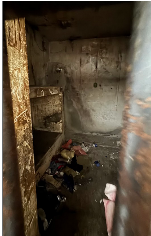
FOTOGRAFIA PESSOAL TIRADA EM 16/06/2025 - ALA A, OUTRA CELA COM A GRADE SERRADA, INUTILIZADA PARA CUSTÓDIA DE PRESOS, MANTIDA COMO DEPÓSITO DE LIXO.
