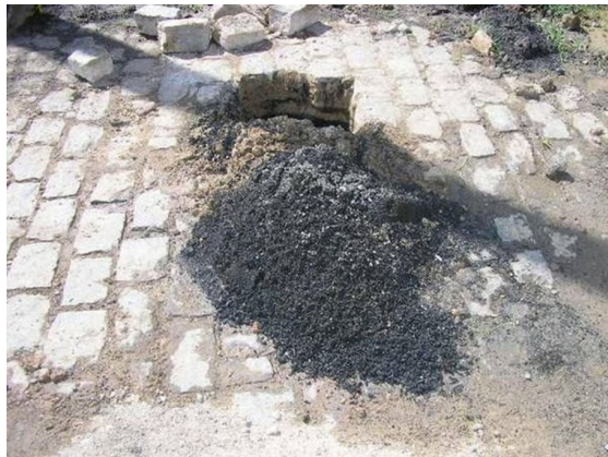
Figura 4 – Escória no meio da rua
