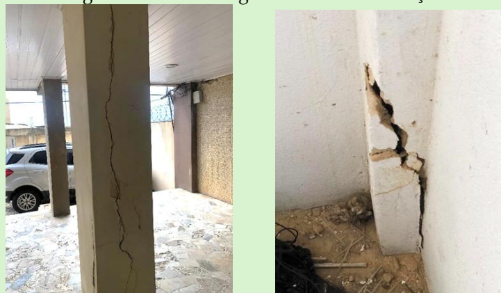
Figura 7 Pilares com grau alto de deterioração
