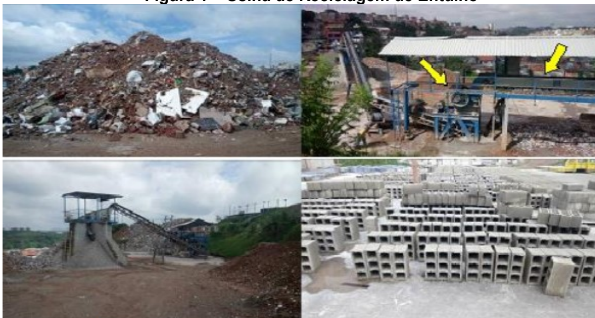
Figura 1 – Usina de Reciclagem de Entulho
