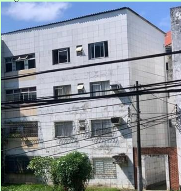
Figura 4 -Manchas de umidade e eflorescências
