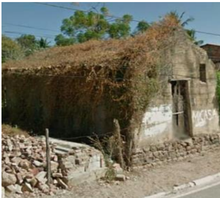
Figura 45- Fotografia da fachada da capela dos Marques em ruínas, localizada na Av. Cel. Antônio Rodrigues Viana- Buritirama, BA
