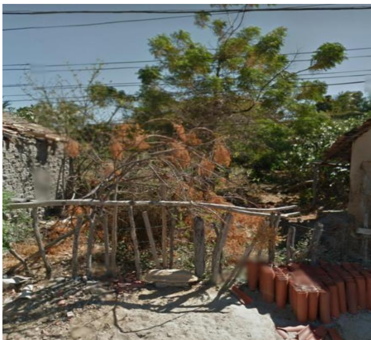
Figura 46 - Fotografia da lateral da capela dos Marques em ruínas
