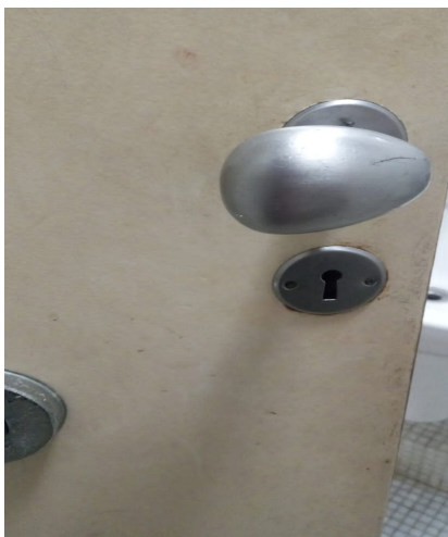
Figura 98 - Maçaneta do banheiro
