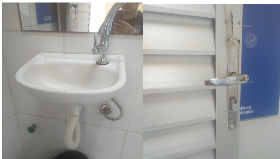
Figura 156 - Irregularidades encontradas nos Banheiros do Parque- 2
