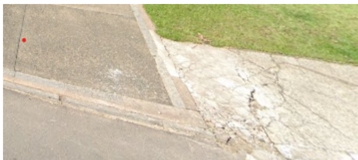
Figura 147 - Piso cimentício e falta de manutenção do passeio
