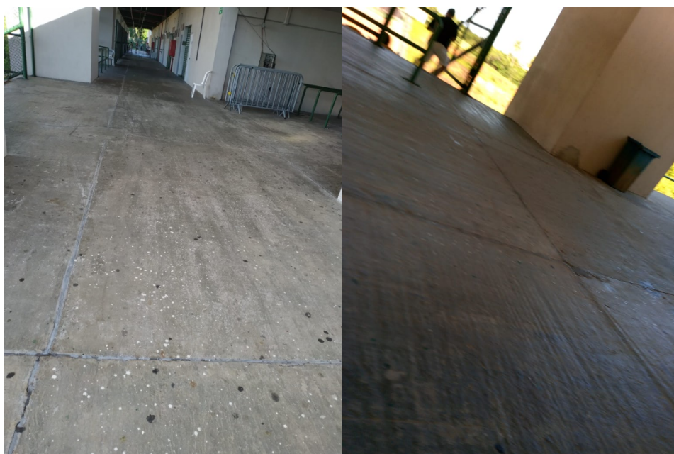
Figura 168 - Piso na área interna do estádio
