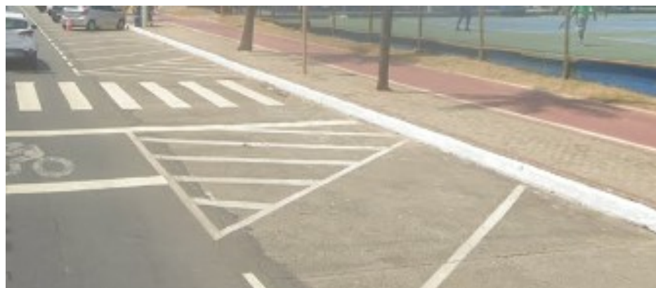
Figura 12 - ausência de rebaixamento de calçadas no Complexo Tenístico Boca do Rio
