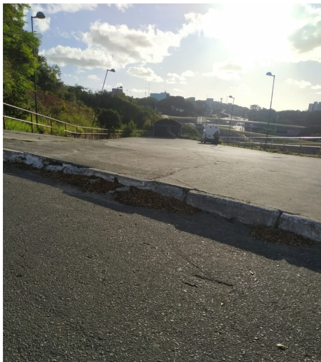
Figura 162 - Acesso ao estádio pelo metrô – calçada sem rebaixamento
