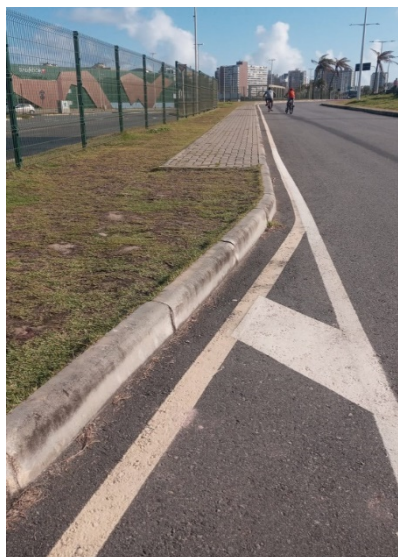
Figura 46 - Ausência de rebaixamento de calçada
