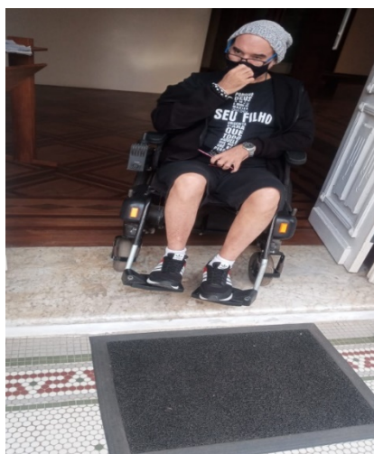
Figura 79 - Desnível 1 do Piso interno
