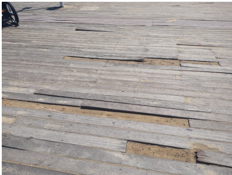
Figura 122 - Piso sem manutenção na Praia de Boa Viagem
