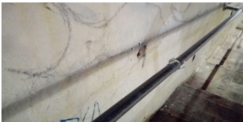
Figura 112 - Corrimão quebrado da rampa de acesso de PcD à praia da Barra
