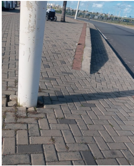
Figura 44 - Inclinação do piso
