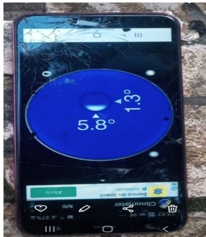
Figura 78 - Inclinação do Piso externo
