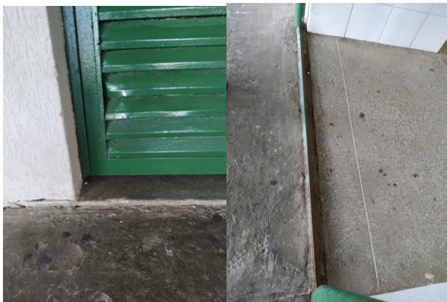
Figura 169 - Piso na área interna do estádio: desníveis
