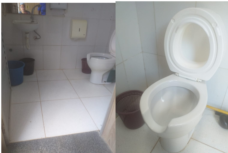
Figura 155 - Irregularidades encontradas nos Banheiros do Parque
