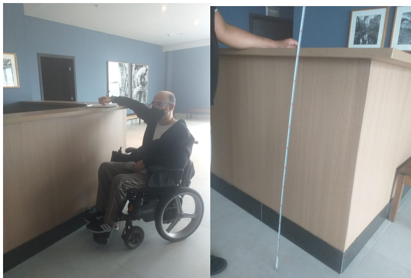
Figura 70 - Altura inadequada do balcão de atendimento do restaurante
