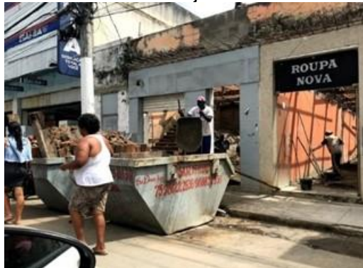
Figura 43 – Calçadas com materiais de construção, na rua Gorgônio J. Araújo
