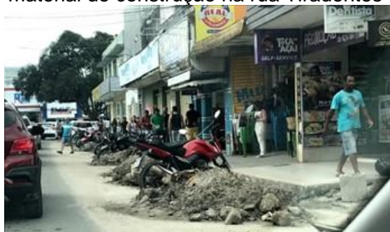
Figura 46 – Depósito de resto de material de construção na rua Tiradentes
