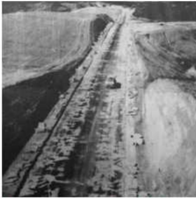
Construção da Avenida Paralela. Fonte: Jornal da Bahia – Os novos caminhos da Bahia - matéria publicada em 22-11-1970
