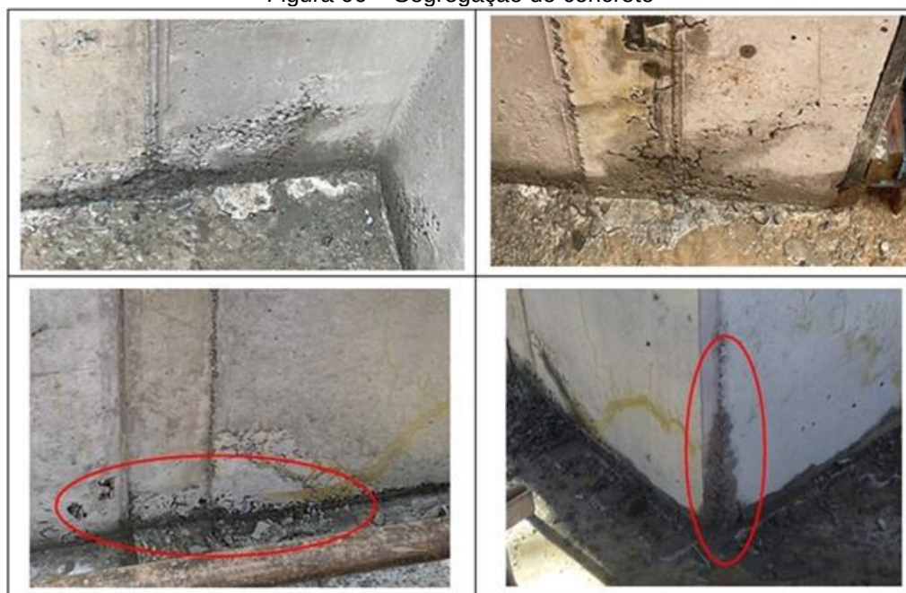
Figura 06 – Segregação do concreto
