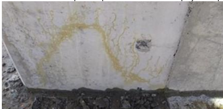
Figura 07 – Manchas na parede por desmoldante e espaçador aparente
